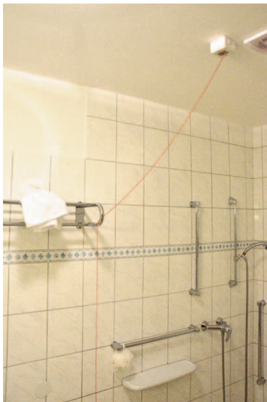
Fot. 4. System przywołania pomocy w strefie kąpielowej w postaci czerwonego sznurka zamocowanego do sufitu
